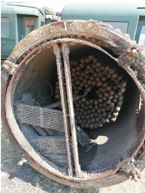
Le dessous de la chaudière avec ses tubes d'eau
