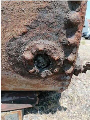
Autoclave de chaudière
